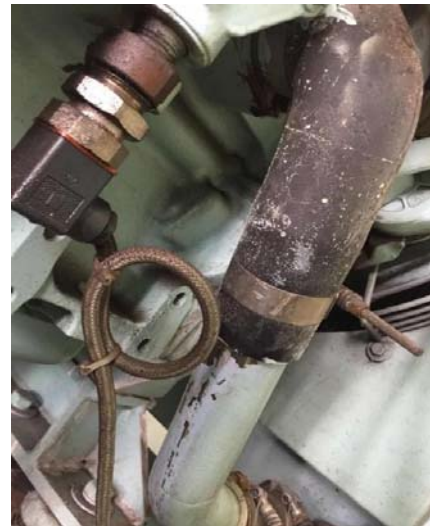
EM D.G leak of cooling liquid
