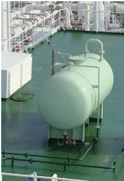
图2. 2. 3. 2 (2) 乙二醇储存柜
