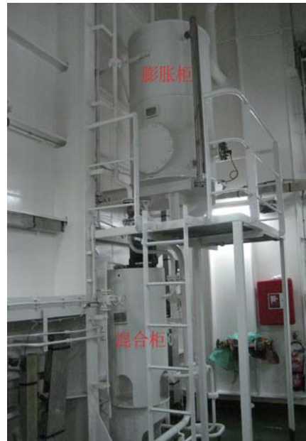
图2. 2. 3. 2 (3) 乙二醇/水膨胀柜和混合柜
