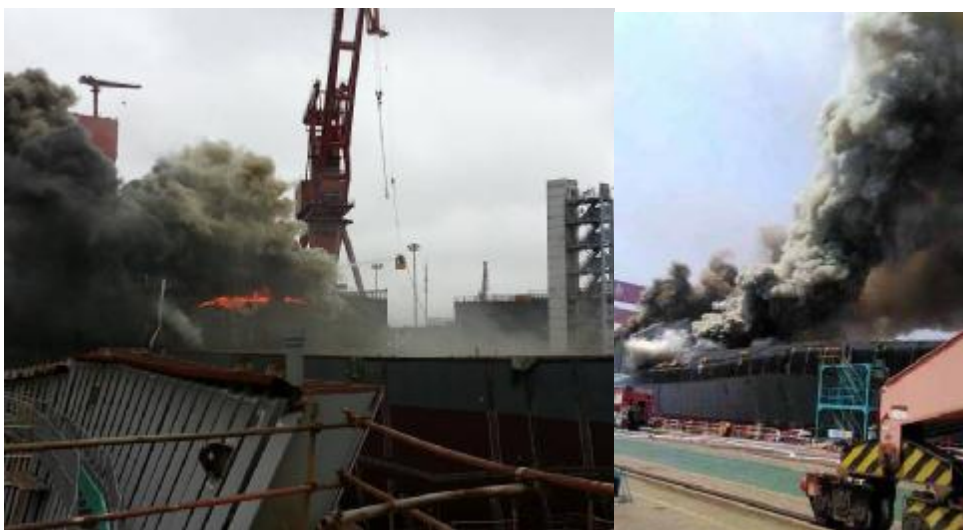
图27- 液化气体舱在建造过程中严重失火
