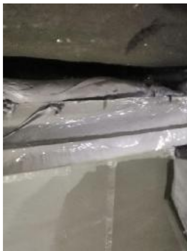
图28- 罐体吊装树脂浇注溢出
