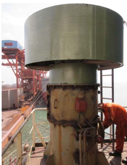
机舱通风筒防火挡板锈蚀烂穿
