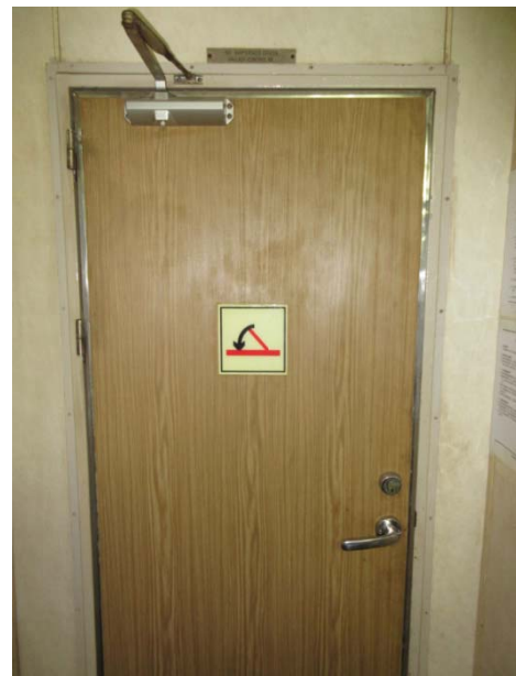
防火门自闭器失效
