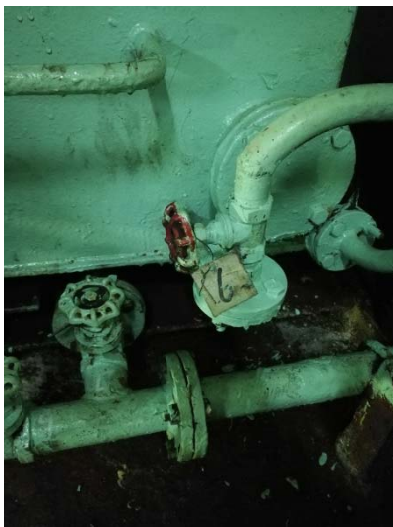
空气冲刷阀#6 开启 (正常情况关闭)
