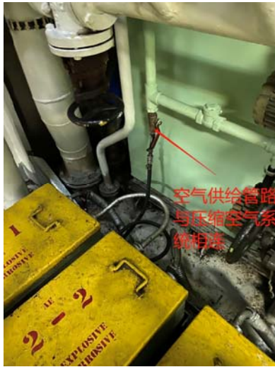
生活污水处理装置失效 (空气泵均不工作)
