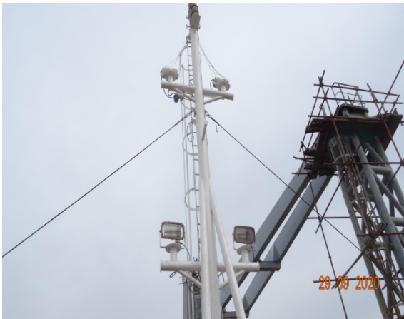
前桅杆安全绳损坏 (已换新)
