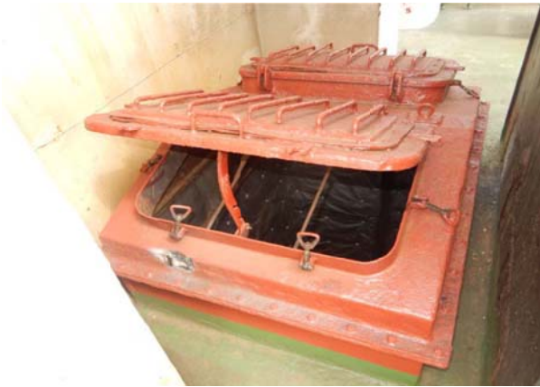
机舱天窗围壁腐蚀洞穿
