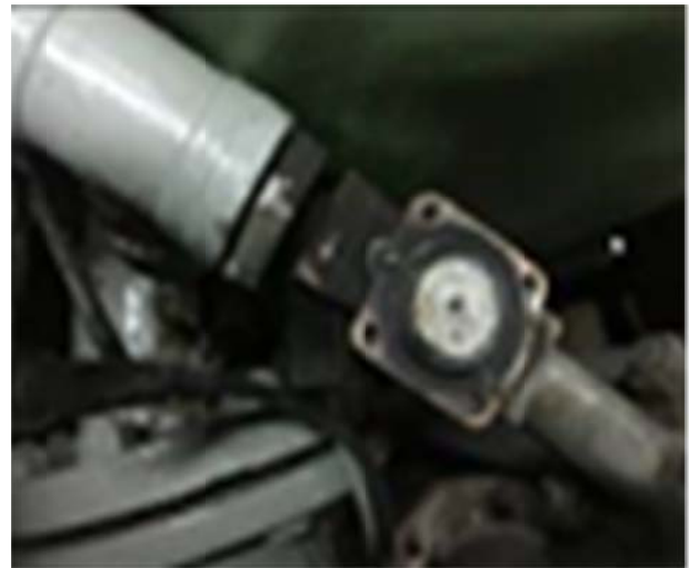
机舱污水泵失效
