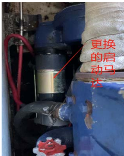
救生艇艇机无法起动
