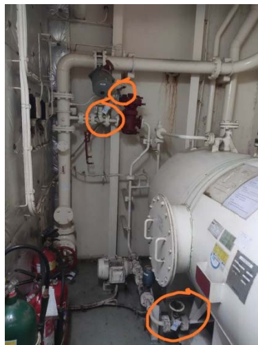
泡沫灭火系统三个操作阀关闭 (应常开)
