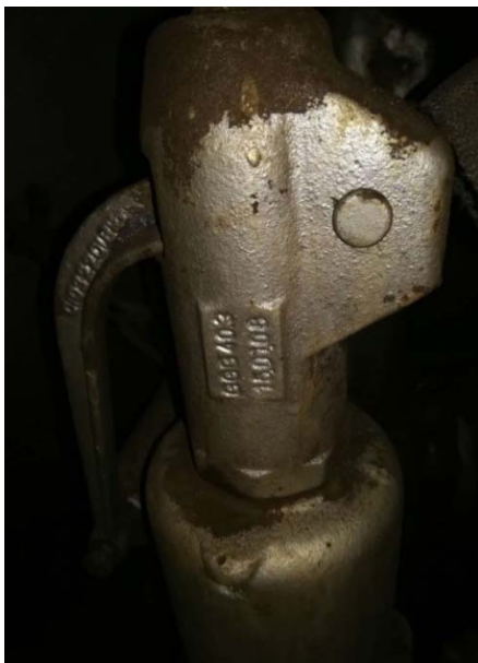
锅炉安全阀手柄销子松脱，不能手动操作
