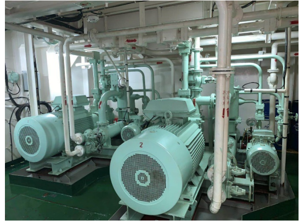
锚机油泵电源盒表面有液压油
