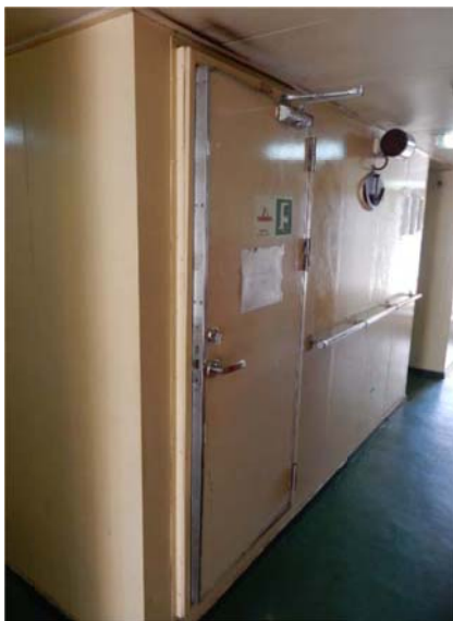
防火门自闭器损坏
