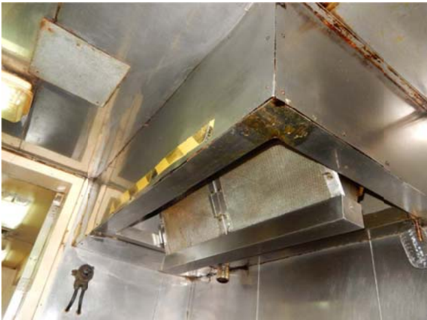
厨房通风管道有油污
