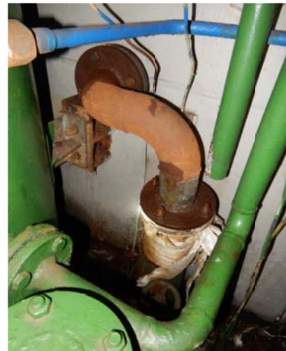
机舱内应急消防泵的吸入管有法兰接头
