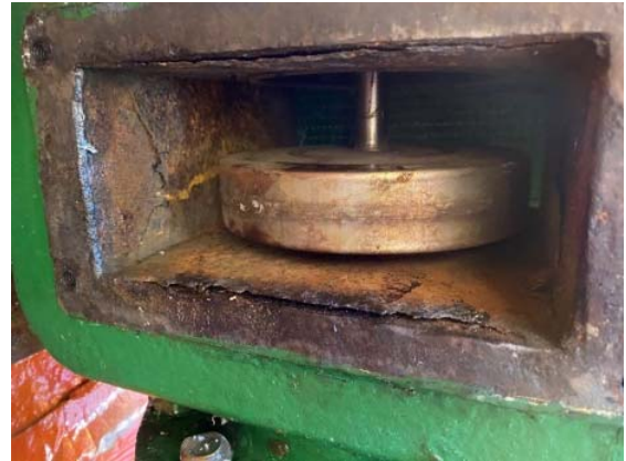
压载舱透气帽和关闭装置失效
