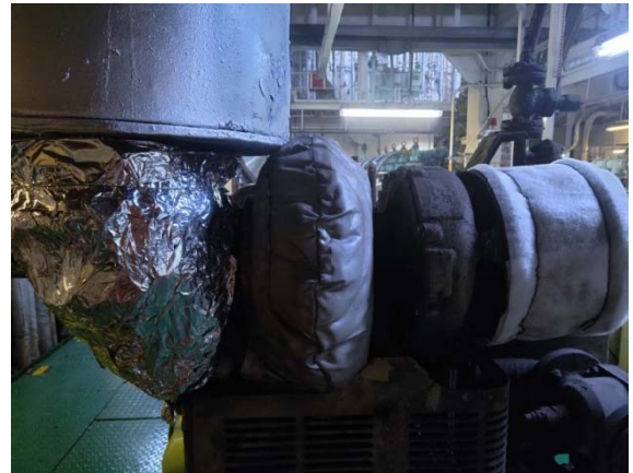
透平和排烟管隔热材料损坏
