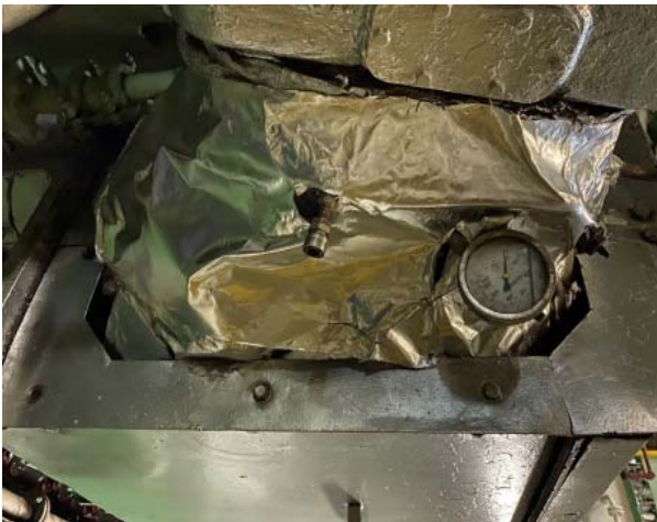
透热绝热层未完全包扎 (修复后)
