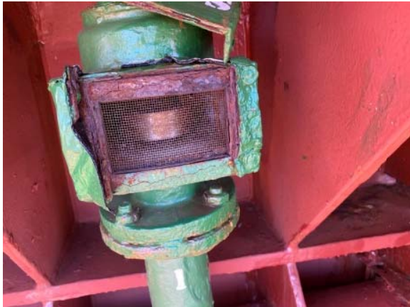
压载舱透气帽和关闭装置失效
