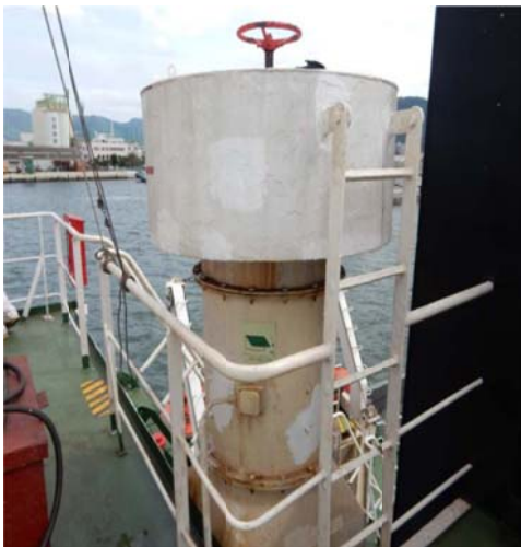
机舱通风筒不能顺畅的关闭
