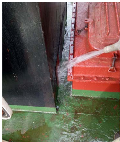
烟囱前壁腐蚀洞穿 (已修复)
