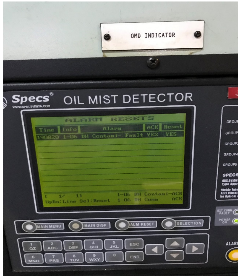
主机油雾探测器失效
