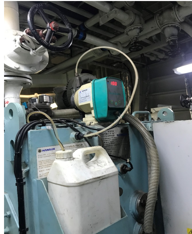
生活污水处理装置投药泵不工作（修复后）
