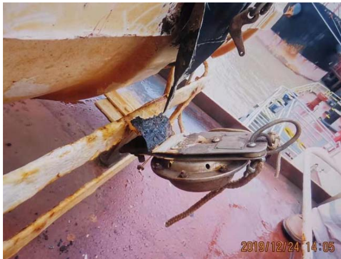
舱静水压力释放器固定铁板锈蚀严重
