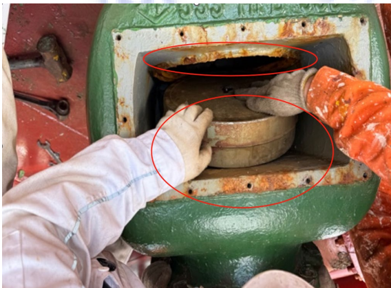
密封胶圈缺失，浮盘脱落
