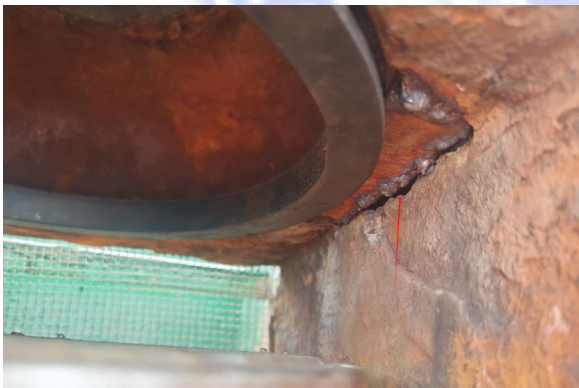
顶部密封圈附近内部结构开裂
