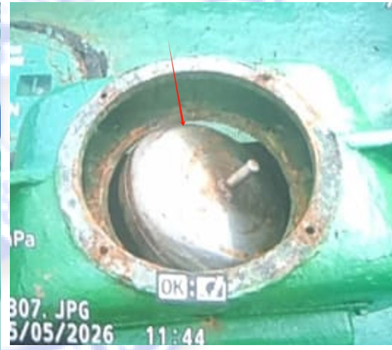
密封圈缺失，浮盘脱落
