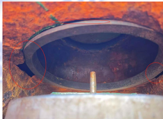
顶部密封圈卡槽锈蚀开裂
