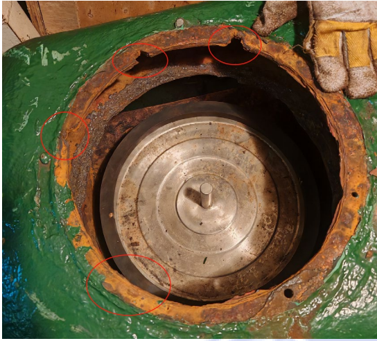
盖板螺栓孔锈蚀失效
