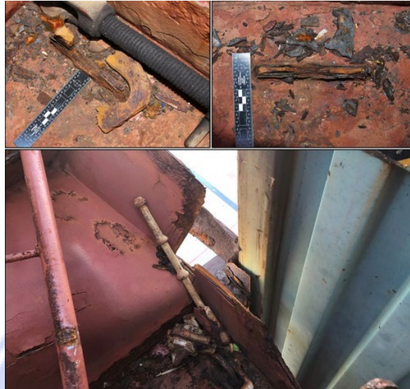
图 1: 被腐蚀削薄、严重损坏并失效的绑扎眼（上图），以及损坏和失效的集装箱支撑结构（下图）
