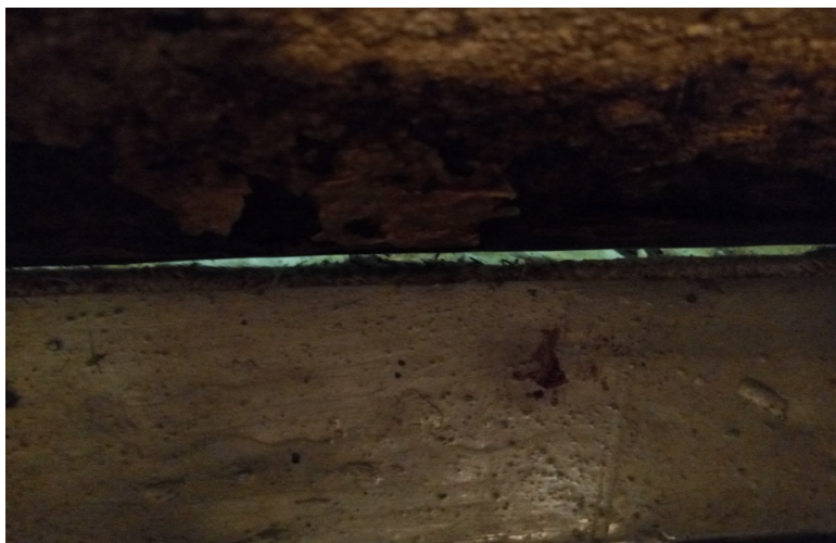
防火门门槛塌陷
