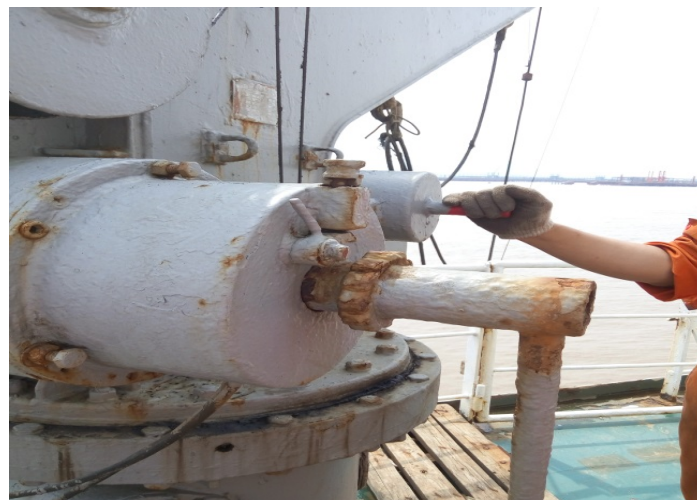
救生筏降落装置故障
