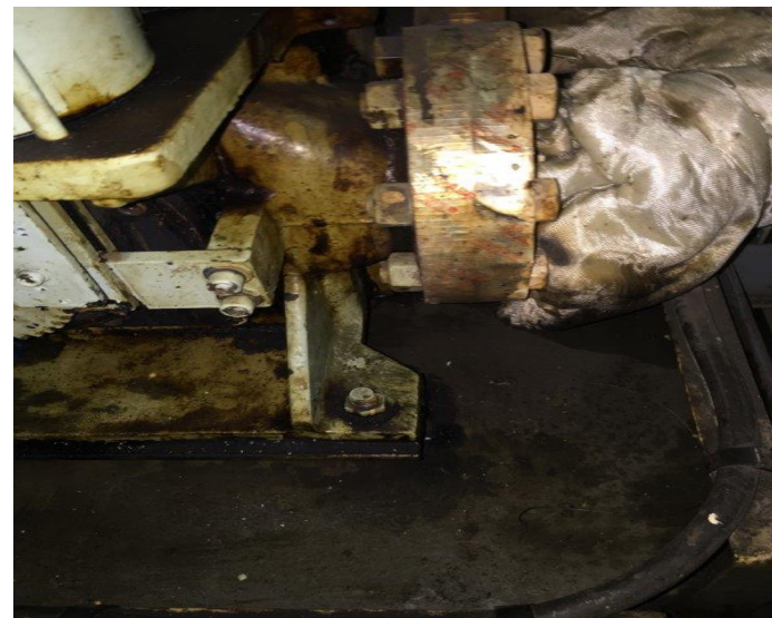
机舱设备燃油/滑油泄漏严重
