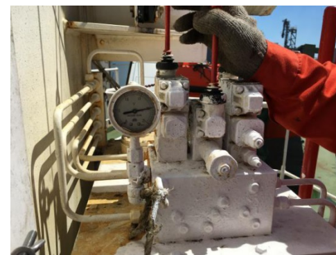
放艇 蓄能罐 的压力 不足
