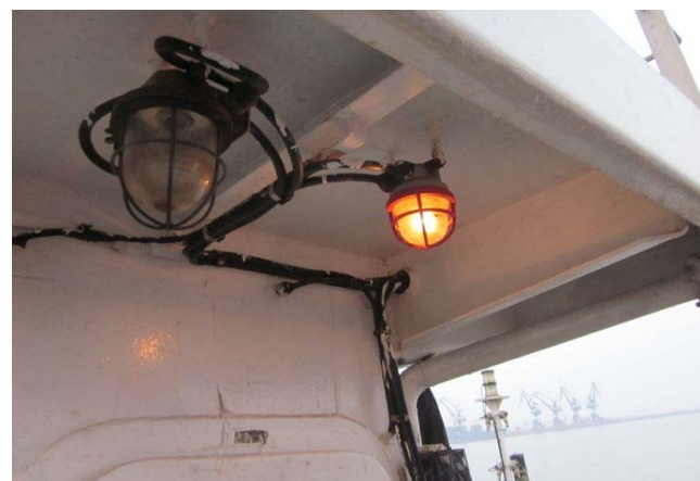
居住舱室外应急照明
