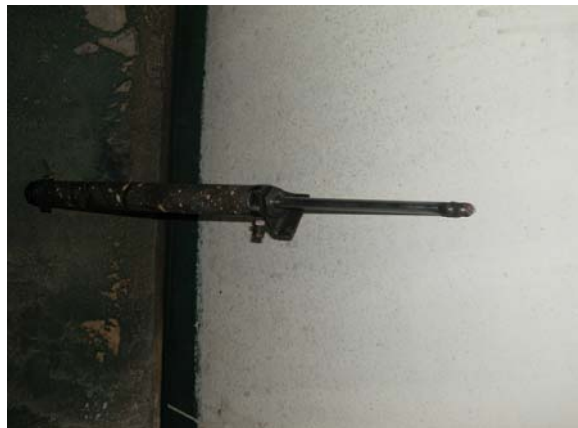
机舱防火风闸气动活塞移动杆断裂处（U 型接头）
