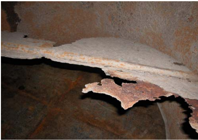
图示：通风筒防火挡板锈蚀严重
