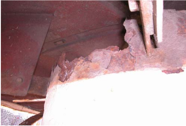
图示：通风筒筒体上端锈蚀严重
