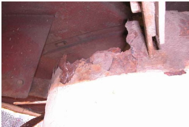
图示：通风筒筒体上端锈蚀严重
