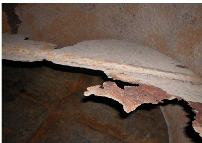
图示：通风筒防火挡板锈蚀严重
