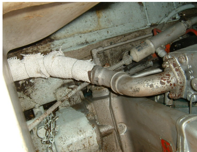
图示：救生艇艇机排气管
